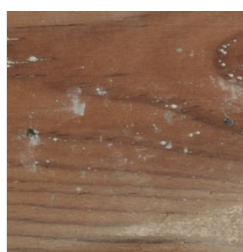
Moisissure en surface
