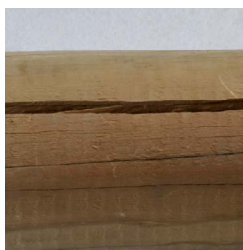
Cracks/Grietas/Fente/Risse/ Crepe/ Barsten/Fendas
