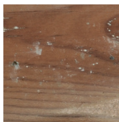
Moisissure en surface
