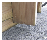
Die Verstärkung muss nicht zwingend den Boden berühren.
